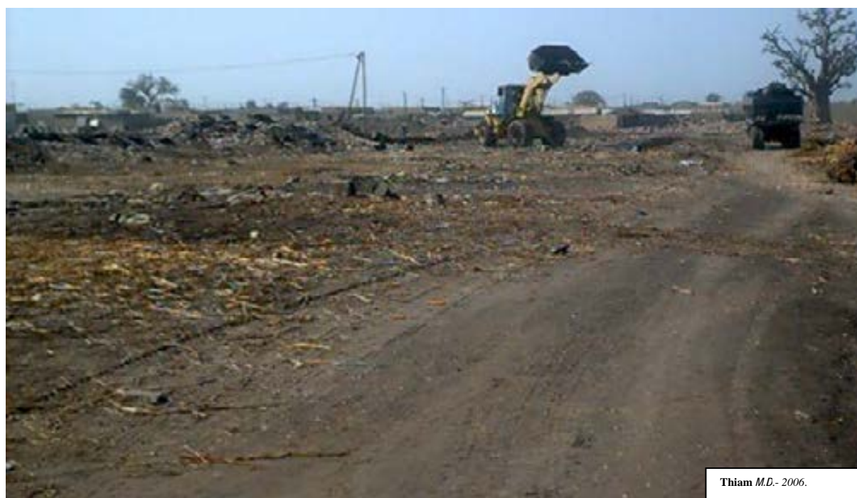
Photo 20 - Déblai de plusieurs camions suite à une forte accumulation de déchets de toutes sortes entre 1992 et 2004. Environ 1000 tonnes de déchets ont été enlevées durant cette période.
