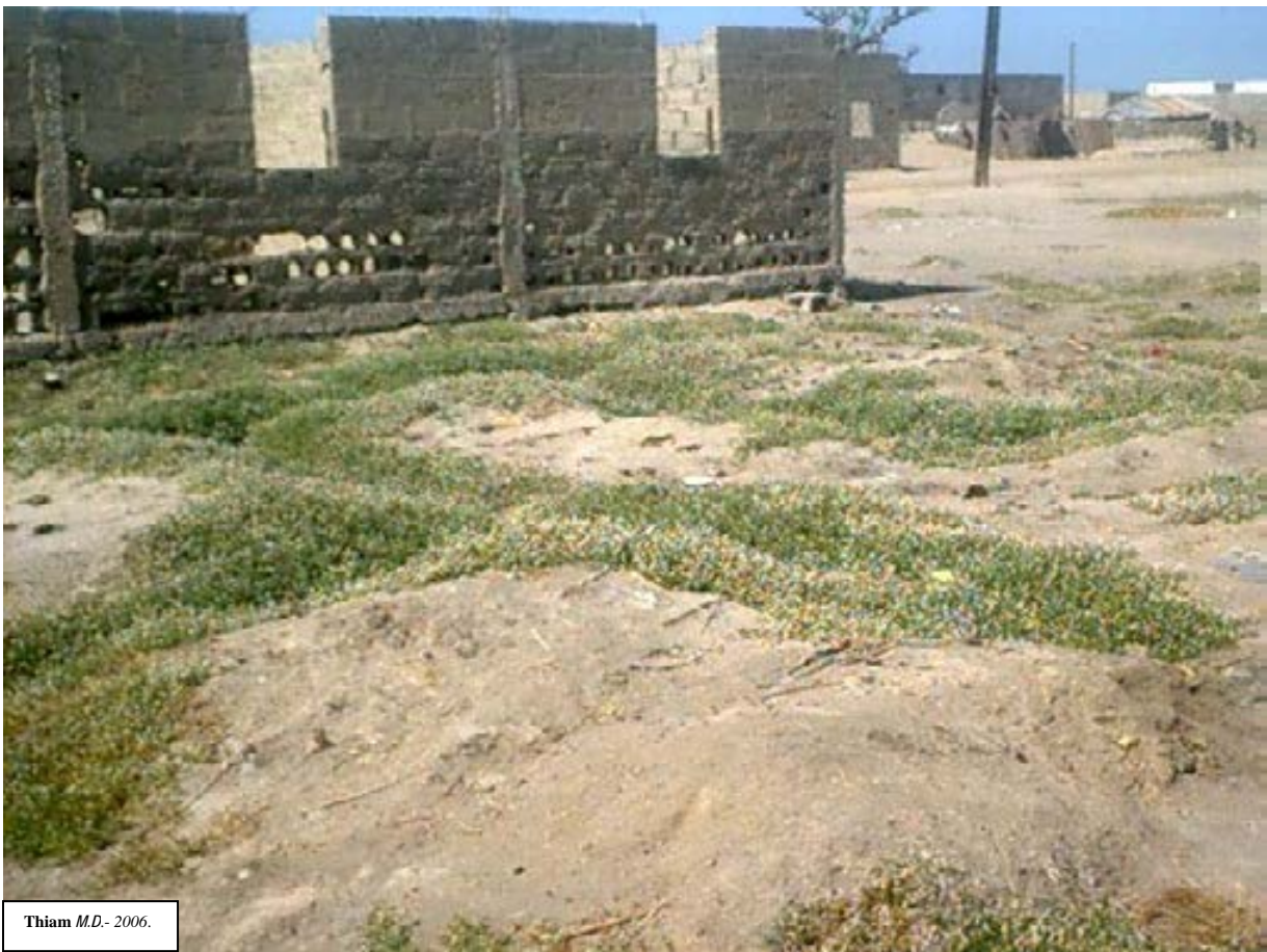
Photo 37 - Action du sel sur le ciment. Cela occasionne bien des abandons de tentatives d'occupation des terrains salés (zone de Khelcom).
