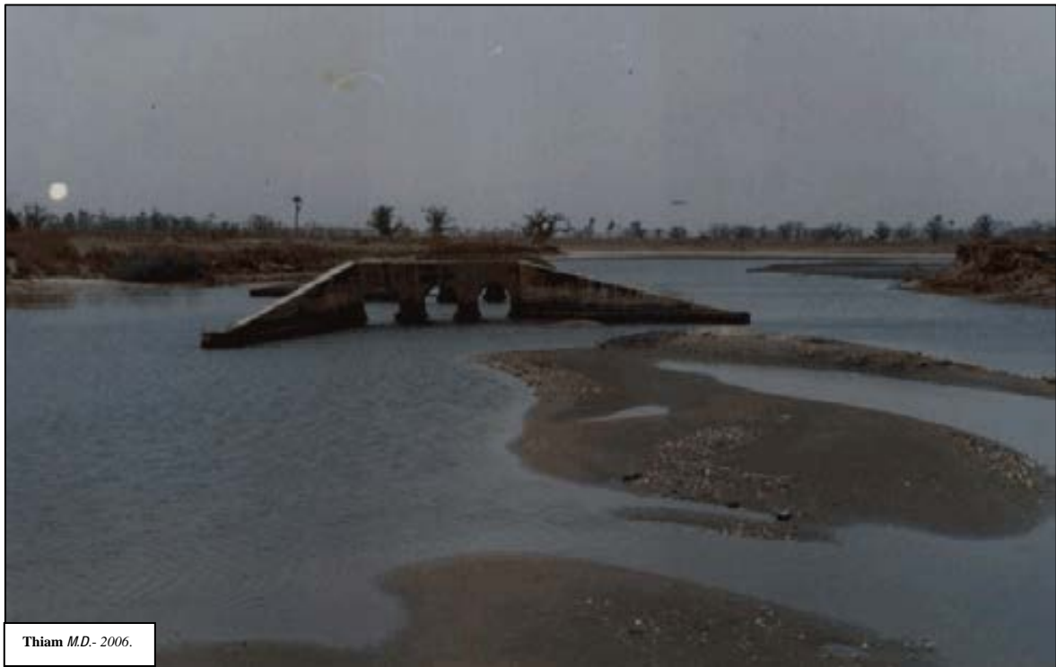
Photographie 19 - Rupture du pont de Fadial durant l'hivernage 1999.
