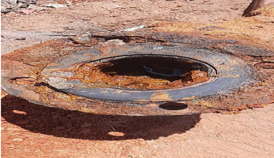
Figure 20 : Corrosion interne sur une vanne
