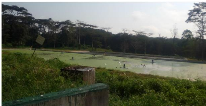
Photo 3 : Bassin aérobie avec aérateurs de surface recouvert d'algues vertes
