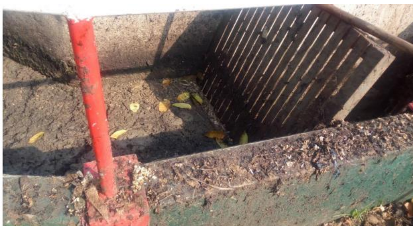
Photo 1 : Dégrillage à barreaux (type artisanal) embourbé sur le canal d'arrivée des eaux usées
