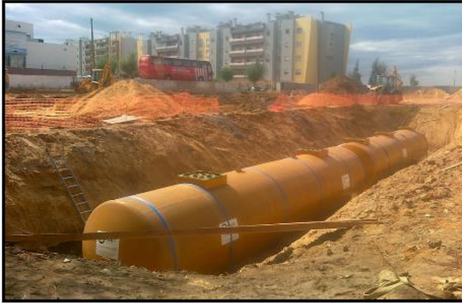
Figure 10: Réservoir sous terrain
