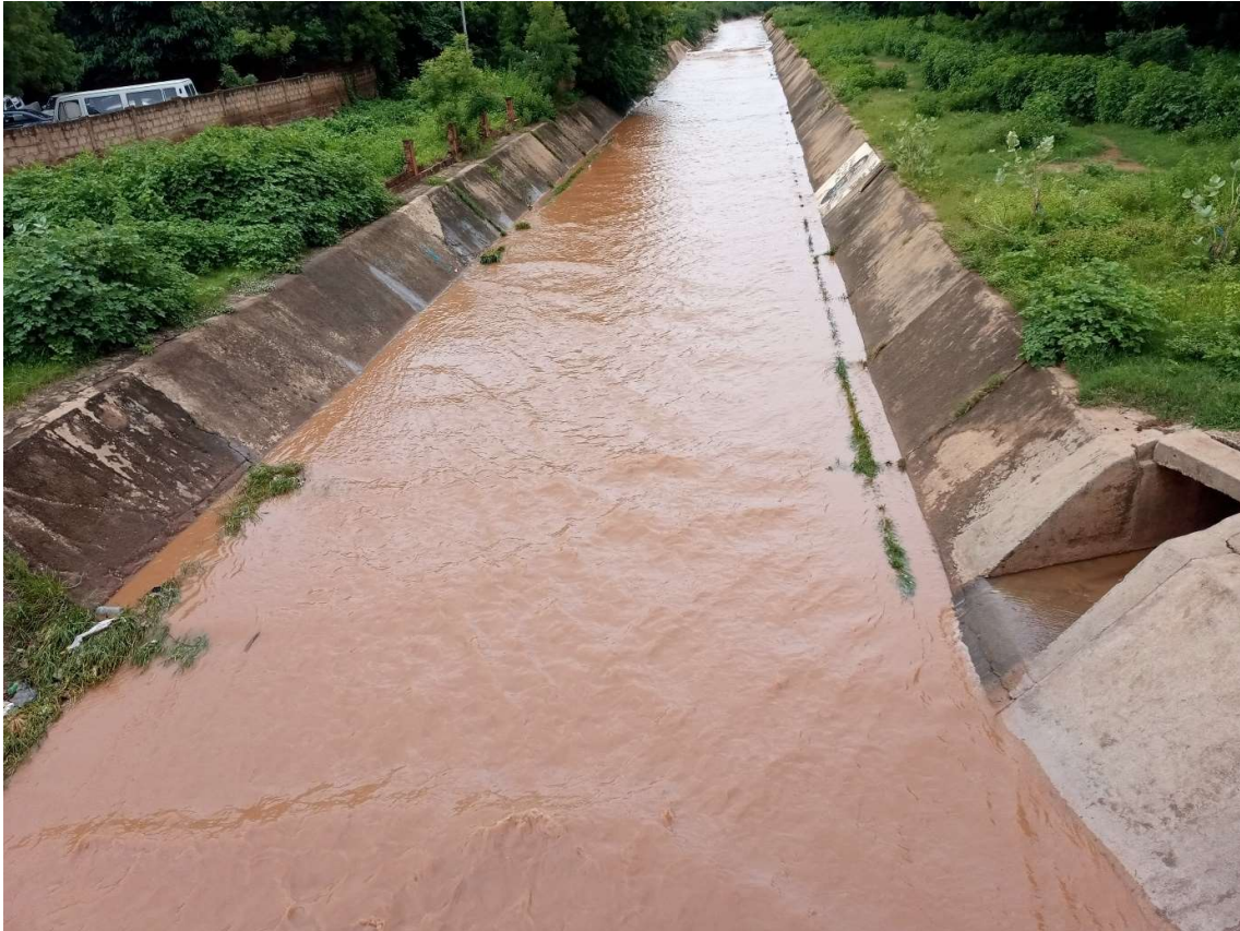
Image 3: Le canal du pont Kadiogo après la pluie du 26 /08/2021
