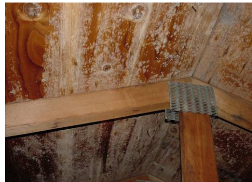
Figure 3 : Dégâts provoqués sur la charpente en bois par Aspergillus niger (Pibiri, 2006)
