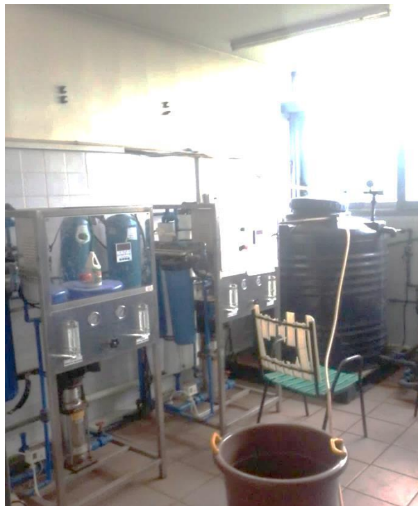
Photo 6 : Salle de traitement de l'eau pour hémodialyse CHUY. (GUEGUIM, 2015)
