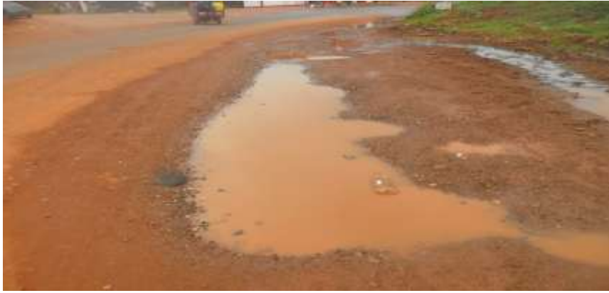
Figure 62. Dégradation due au manque d'assainissement PK 0+020: de la route Abong-Mabng - Bonis 2017
