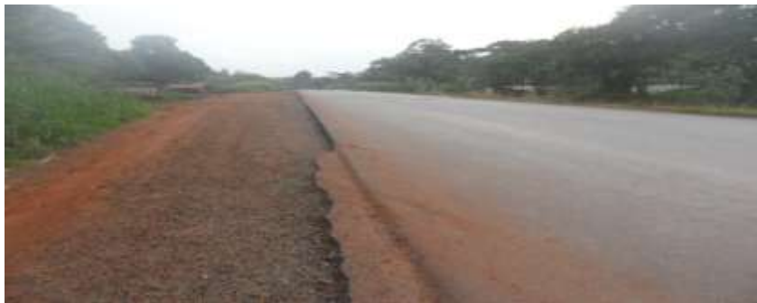
Figure 63. Dégradation due au manque des parkings des gros porteurs PK 52+000: de la route Abong-Mabng - Bonis 2017
