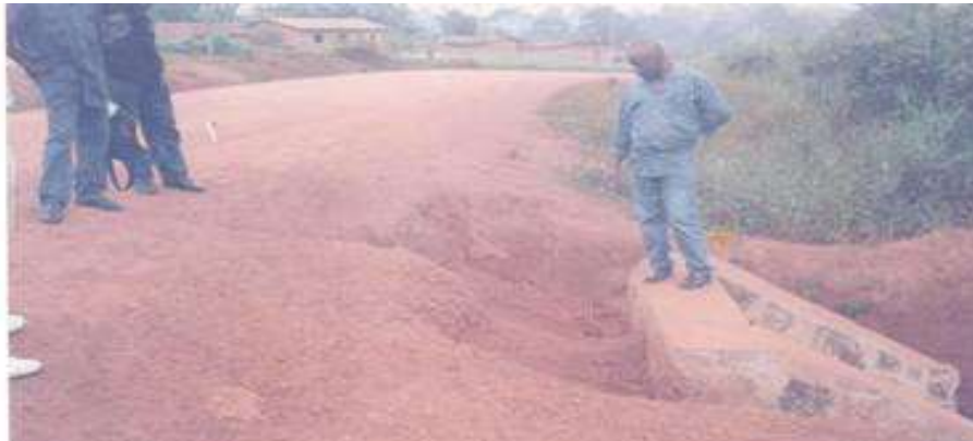
Figure 99 : Dégradation de la chaussée due à l'insuffisance du compactage
