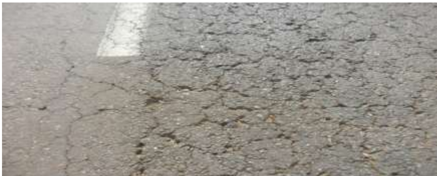
Figure 65. Dégradation due au sous dimensionnement au PK 2+300 de la route Ayo-Ayong-Mbang en 2017
