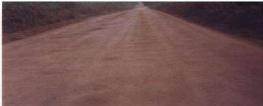
Figure 98 : Tôles ondulées de 10 cm de hauteur au PK 10+500 de la route : Mandjou – Batouri.en 2007
