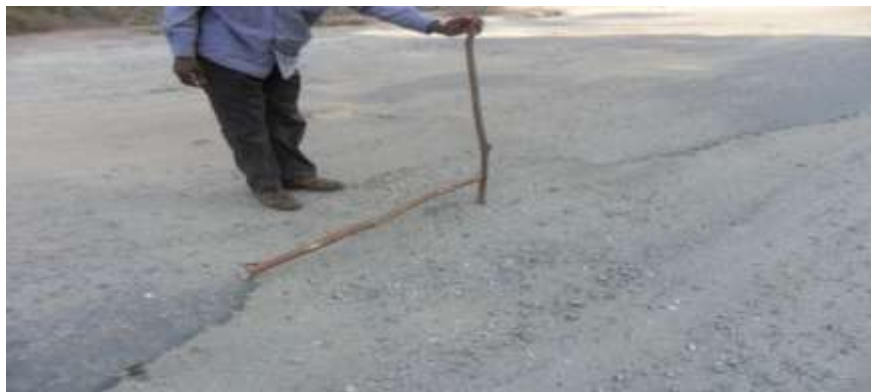
Figure 64. Dégradation due à non protection de la couche de base imprégnée au PK 72+000 de la route Abong-Mbang - Bonis 2009
