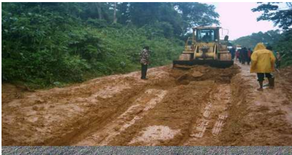
Figure 103 : Dégradation de la chaussée au PK 30 + 000 de la route Yokadouma-Bangoué à cause de la nature des matériaux pendant la saison de pluies en septembre 2007
