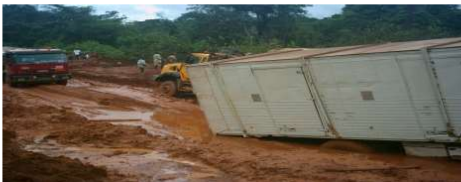
Figure 100 : Détérioration de la chaussée par le trafic des poids lourd, à cause d'une buse obstruée faute d'entretien courant sur la route : Ngoura – Yola (78 km) au PK 3 + 000 en 2007
