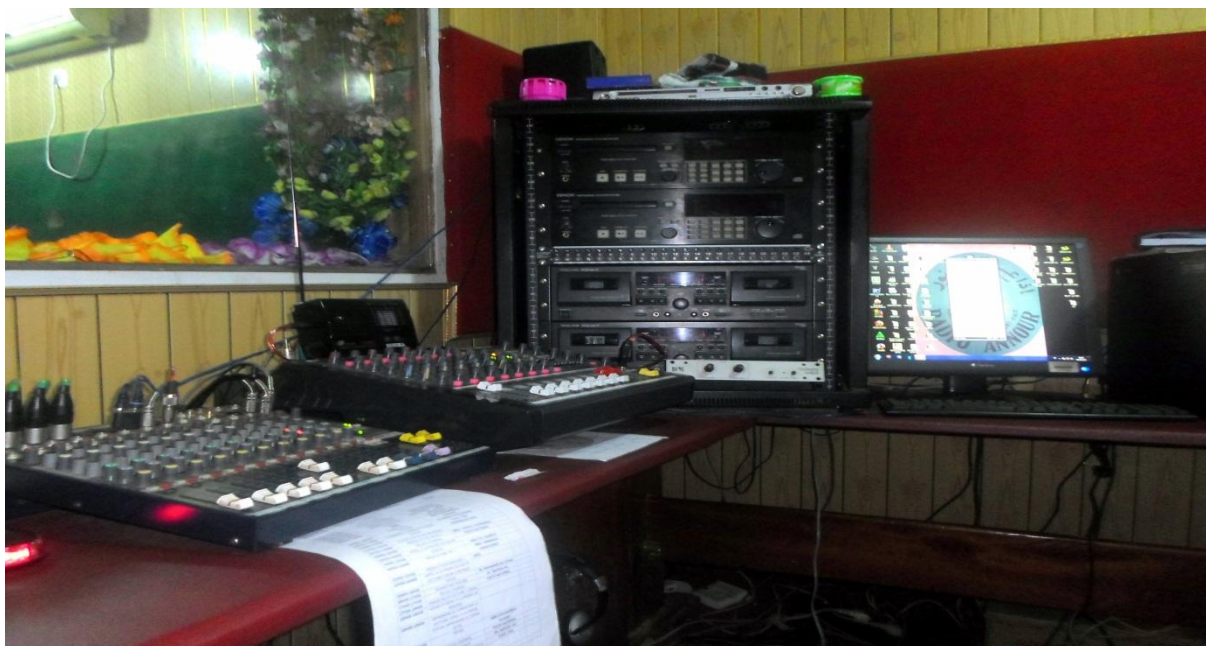
Photo 7: une vue de la cabine technique de la radio ANNOUR
