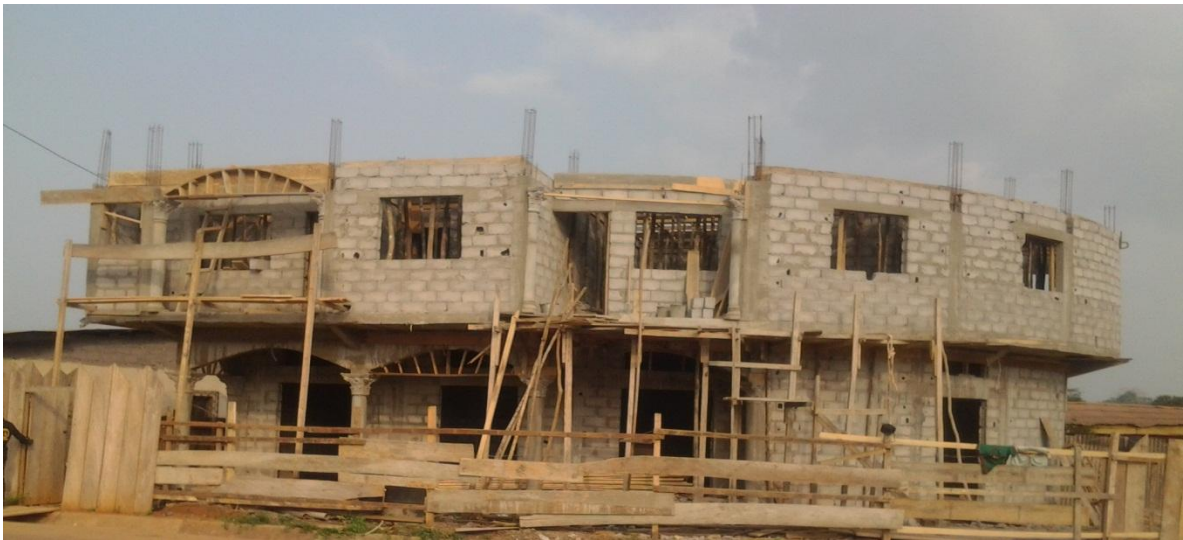
Photo 9: Un chantier abandonné victime des querelles improductives
