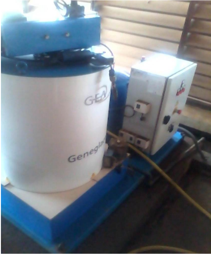
Photo n° 4 : Appareil de fabrication de glace du CECOPAK
