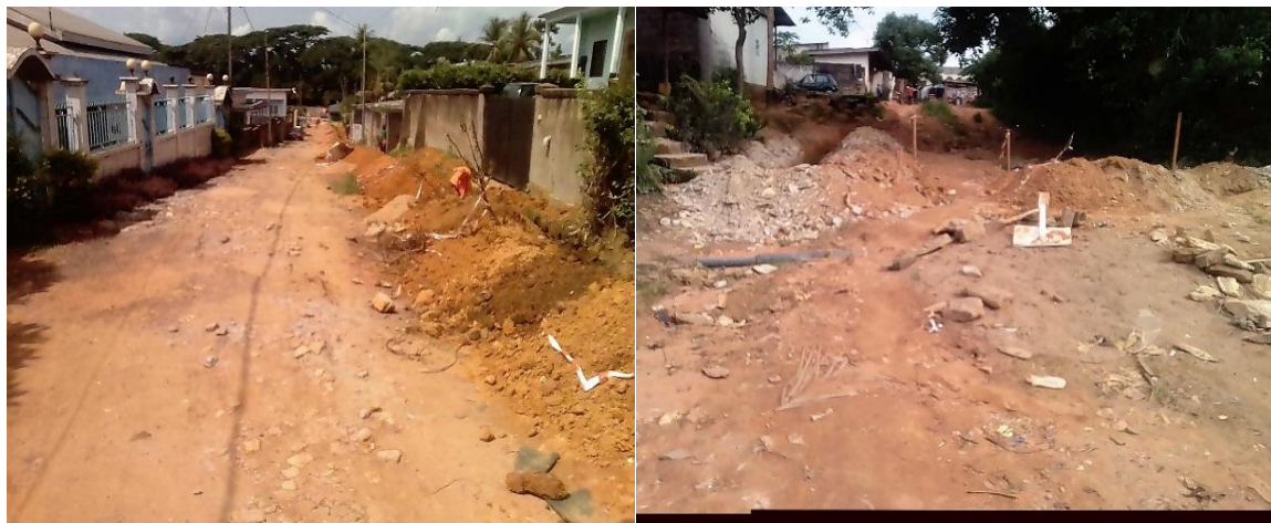
Photo 20 : Programme d'adduction d'eau dans la ville d'Edéa (les quartiers Bonaminkengué et Domaine)
