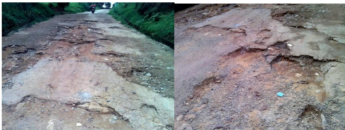
Photo 18: Axe sous-préfecture-lycée bilingue d'Edéa
