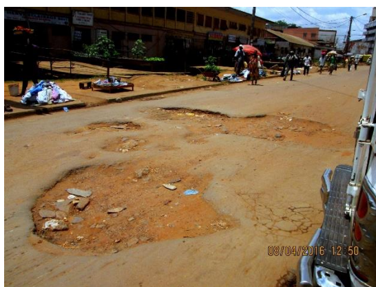
Photo 6 : Route dégradé en plein centre de ville de Yaoundé
