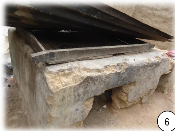
Photo 6 : Enfumoir en mauvais état réalisé par le SILEM
