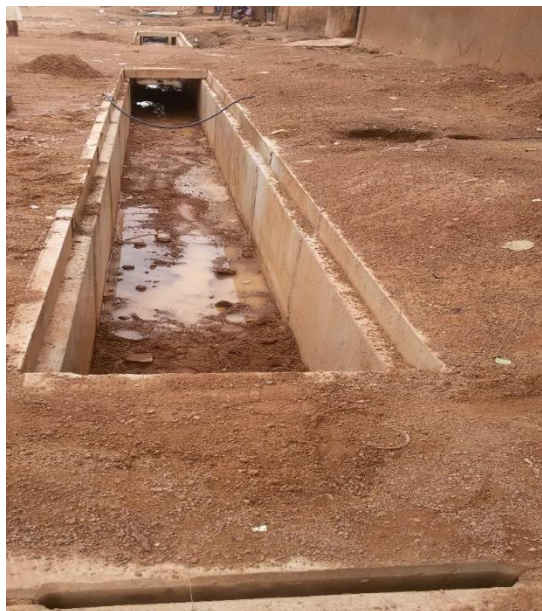
Figure 8 Image d'un collecteur secondaire au quartier Cissin. Source : Enquête de terrain, août 2018
