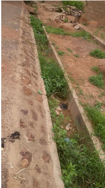
Figure 9 Photo d'un collecteur tertiaire au quartier Ouaga 2000.
