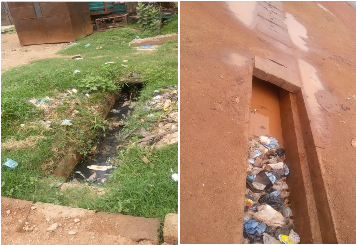
Figure 10 Photo d'un collecteur tertiaire comblé au quartier cité An III.
