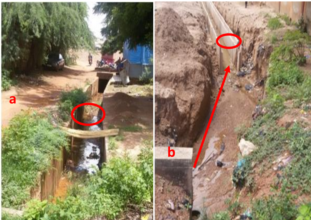
Figure 14 Photo illustrant les défauts de construction (a) et de continuité de collecteurs secondaires (b) au quartier Cissin à Ouagadougou.
