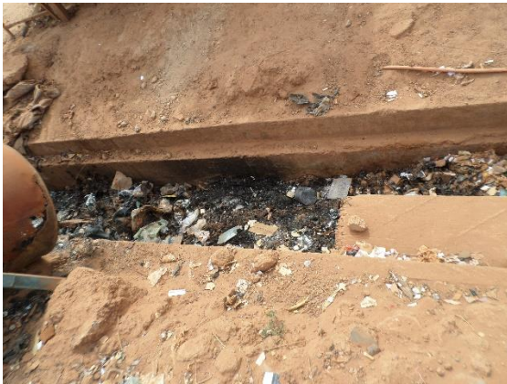
Egout rempli de déchets
