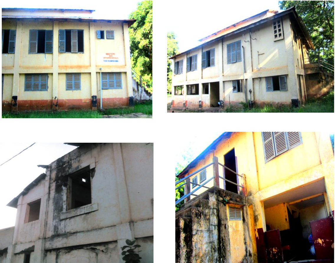
Figure 6 : Photos des bâtiments en dégradation sur le site de Kamina. Auteur, 2016.
