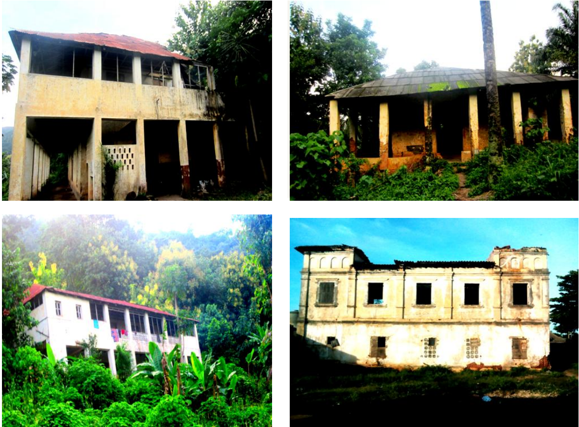
Figure 7 : Photos des bâtiments en dégradation avancée sur le site de Missahoe et Aného. Auteur, 2016.
