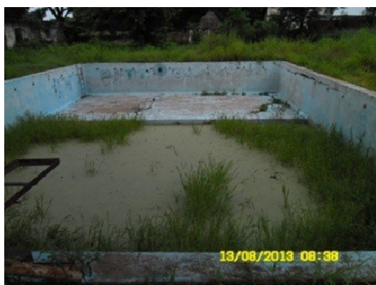
Figure 49 Image de la piscine en état de délabrement (Photo 2013)
