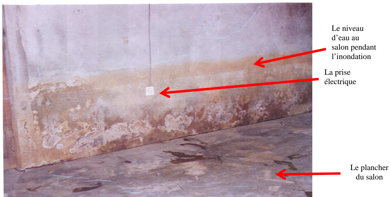
Photo 06 : Effet de l'inondation sur les habitations à Godomey-Togoudo
