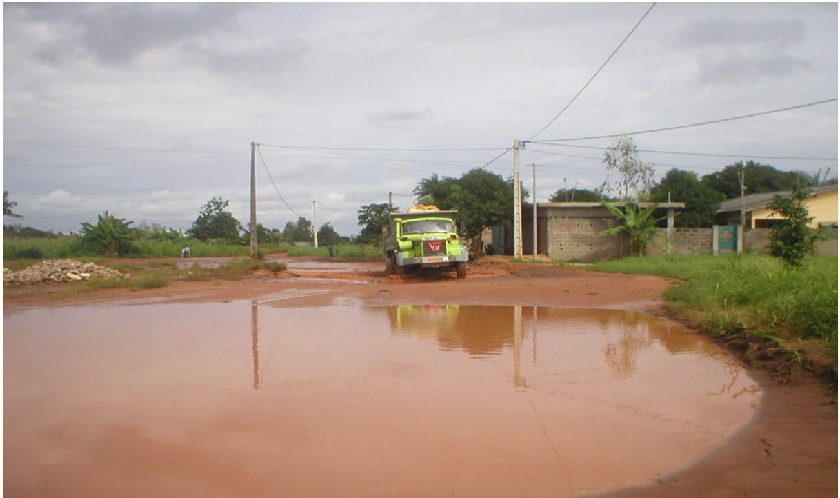
Photo 25 : Voie en terre dégradée et remplie d'eau rendant la circulation difficile aux usagers à Dowa (Cliché VIGNINO, juin 2009)
