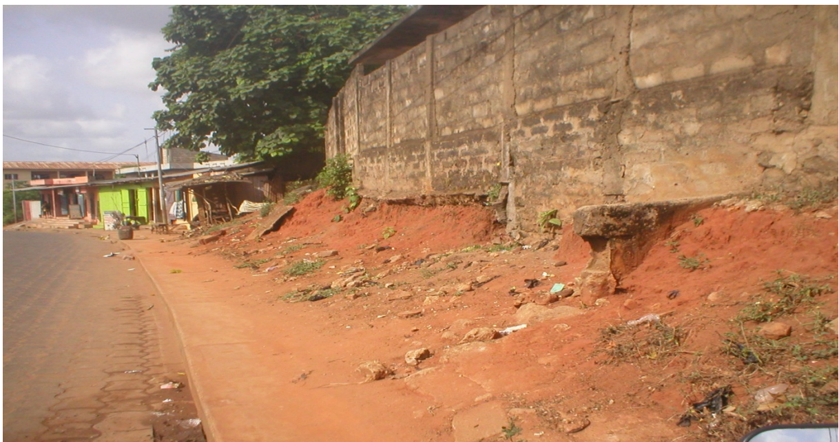
Photo 28 : Bâtiment menacé par l'érosion à Agbokou (Cliché VIGNINO, juin 2008)
