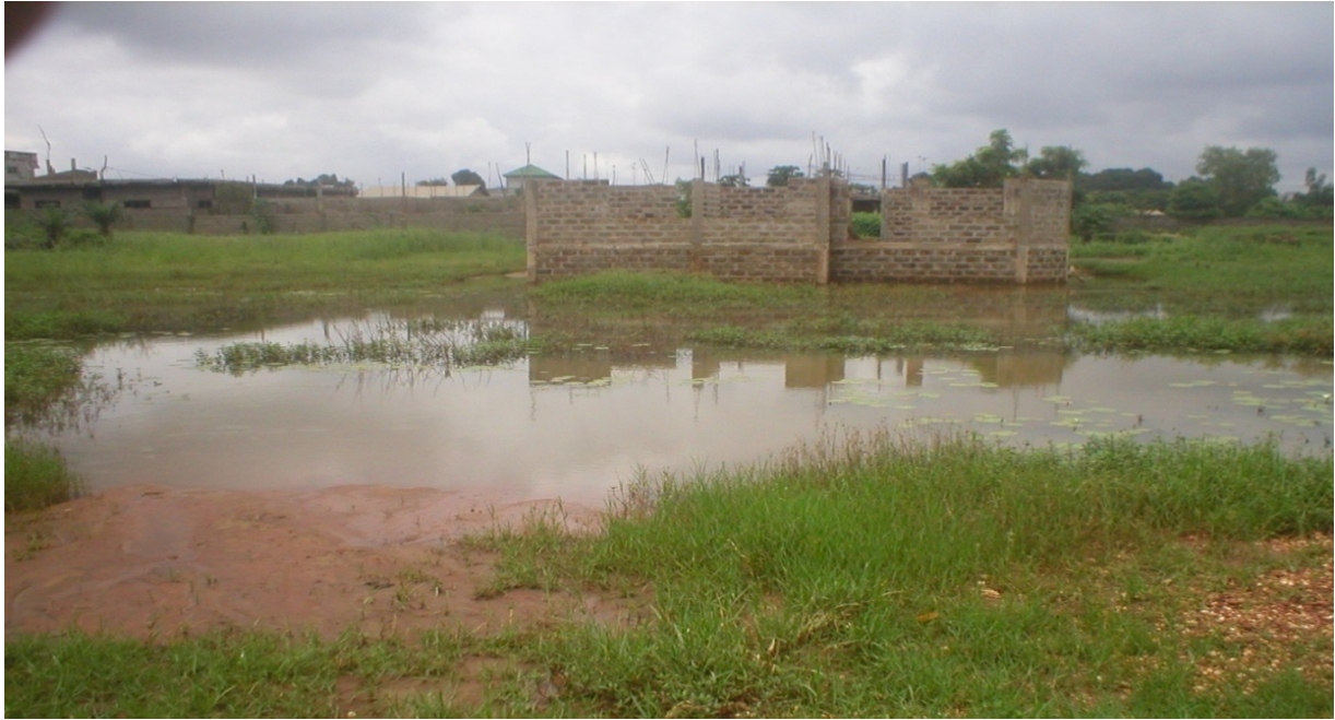
Photo 26 : Maison en chantier dans une zone inondable à Malanhoui (Cliché VIGNINO, juin 2009)
