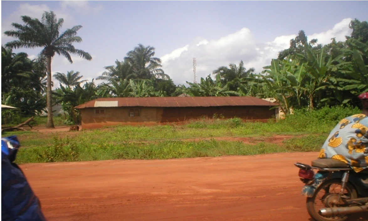
Photo 11 : Habitat traditionnel, en banco dont une partie est crépie et l'autre non crépie, couvert de feuilles de tôle pratiquement rouillées dont une partie est remplacée par deux ou trois feuilles de tôle neuves à Akpro-Misséré, (cliché VIGNINO, Mai 2009).
