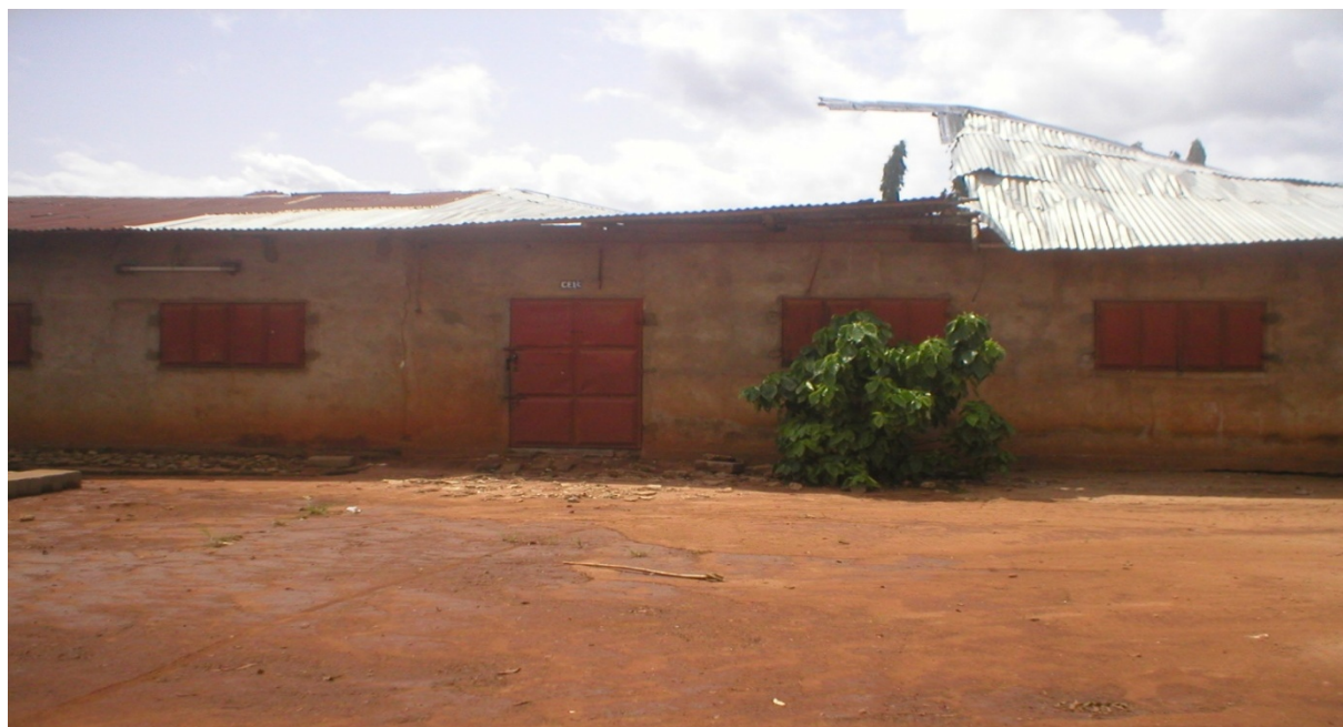
Photo 31 : Toiture décoiffée par un vent violent dans l'école primaire d'Akonaboè (cliché VIGNINO, juin 2009)
