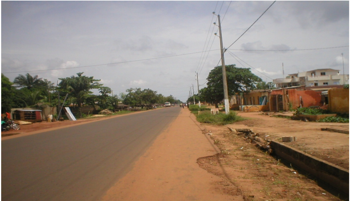
Photo 27 : Début de dégradation de la voie bitumée et caniveau non entretenus à Akpro-Misséré (Cliché VIGNINO, juin 2008)
