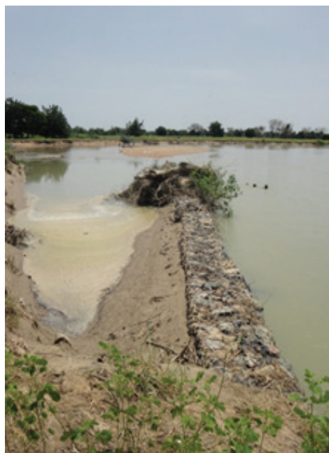
Photo 1 : les menaces d'érosion dans le cours du Mayo Tsanaga ont obligé l'administration à dévier le lit pour sauver les villages environnants et construire une digue pour protéger le pont. Cette digue est aujourd'hui attaquée par l'érosion.
