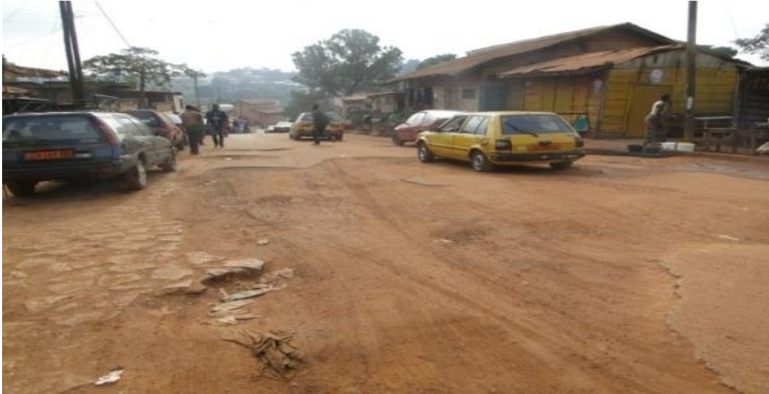
Fig.1 : Etat de dégradation avancée des voies projetées à Mvog Atangana Mballa et Mvog-Mbi
