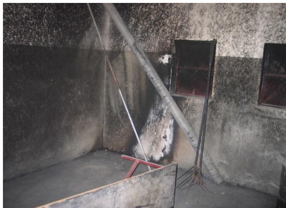
B : salle d'accouchement du centre de santé
