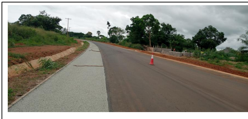
Photo 2 : État de la route Nationale N°15
