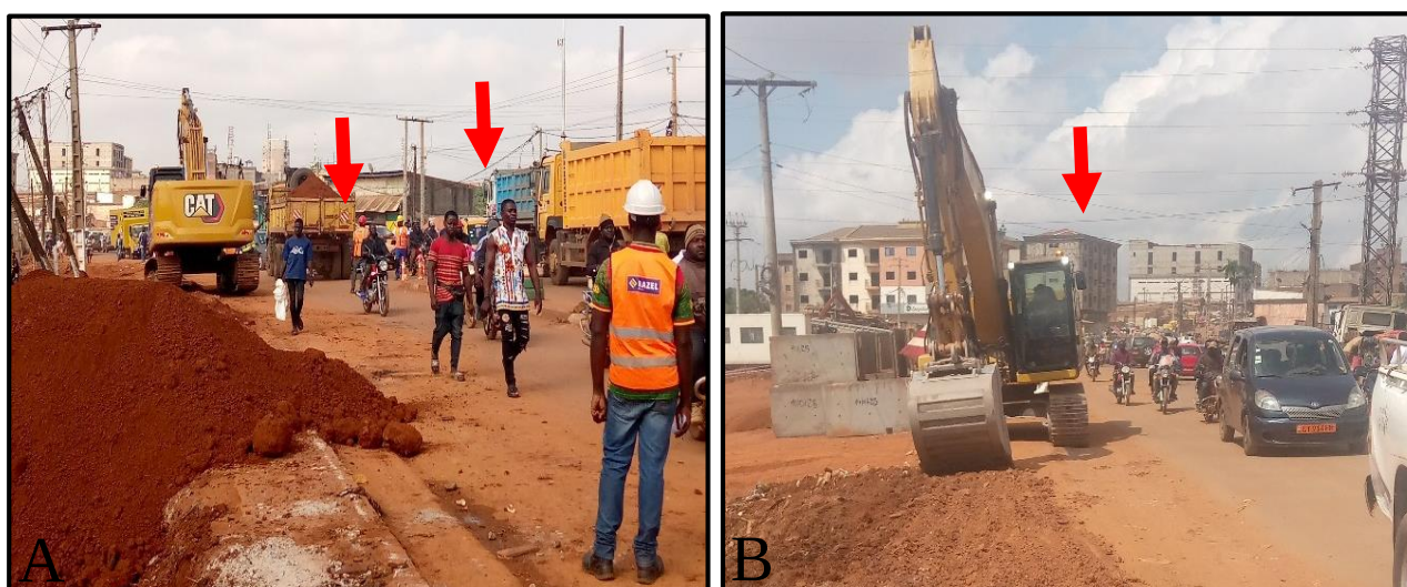
Figure 20: Délimitation carentielle des zones de travail. A , une zone de manœuvre des engins et des camions où circulent en même temps des piétons, exposés aux risques d'écrasement ; B , une pelle excavatrice en pleine manœuvre à proximité d'une voie, sans que la zone de travail ne soit signalée et délimitée, et sans qu'il y ait un signaleur pour orienter la circulation et le conducteur de l'engin.
