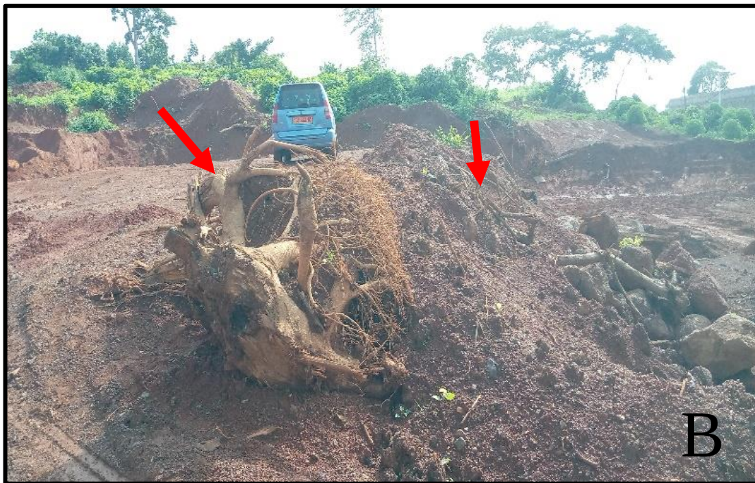
Figure 10: Vues de la destruction de la flore dans le site d'emprunt latéritique. A , tractopel le extrayant la latérite au péril de la flore ; B , débris d'arbres détruits dans le site d'emprunt latéritique.
