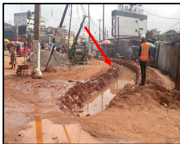
Figure 14: Eaux usées stagnantes sur le chantier
