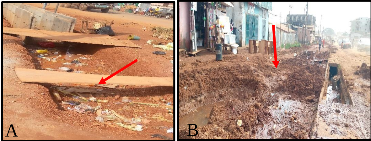
Figure 13: Gestion carentielle des déchets sur le chantier. A , déchets accumulés dans une excavation ; B , terre bourbeuse rendant le cadre de vie insalubre.
