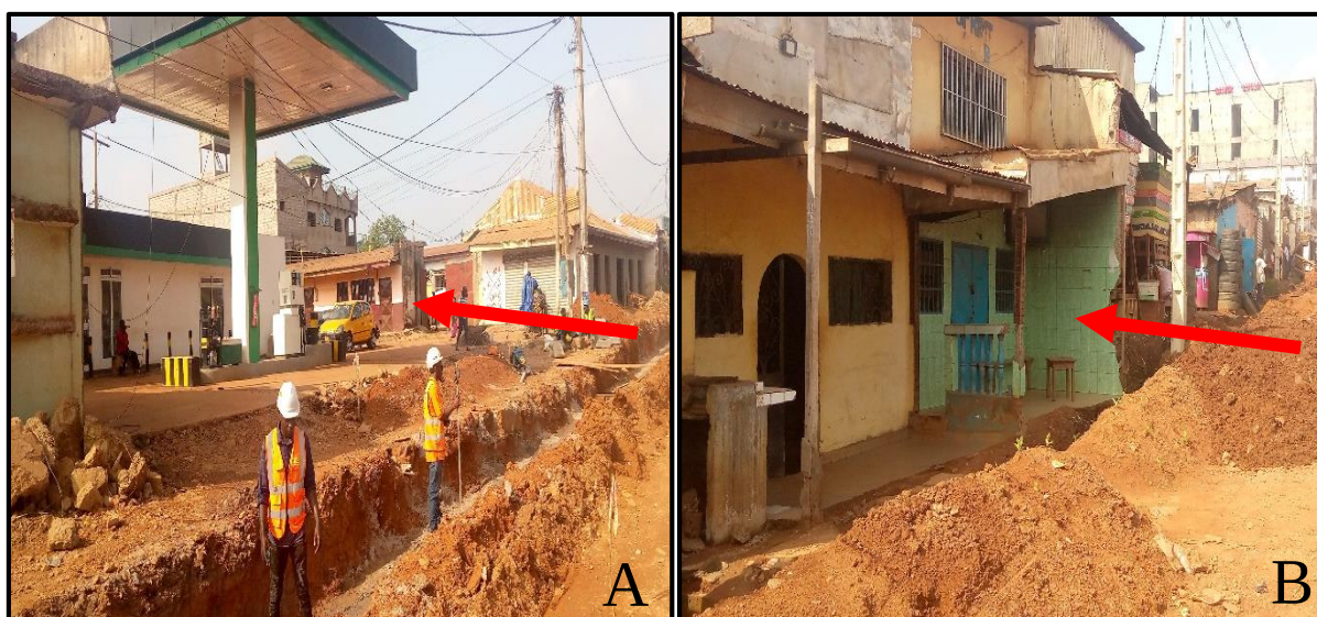
Figure 26: Illustration de la perte des biens des riverains. A , station d'essence hors service à cause du projet ; B , un restaurant hors service aux murs détruits et sans voie d'accès.
