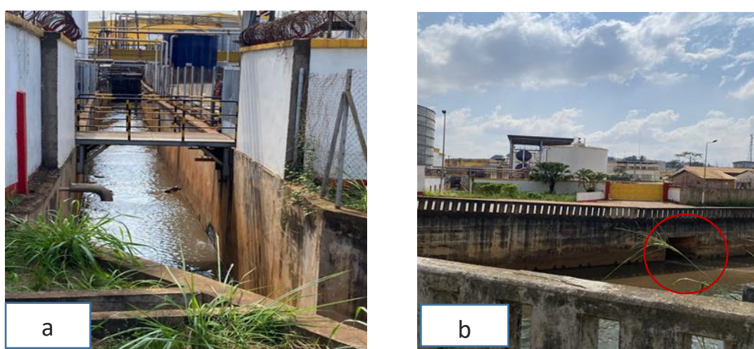
Fig 6: Image relative à la gestion des effluents : a) Sortie des eaux de rejet, b) exutoire des eaux de rejet.
