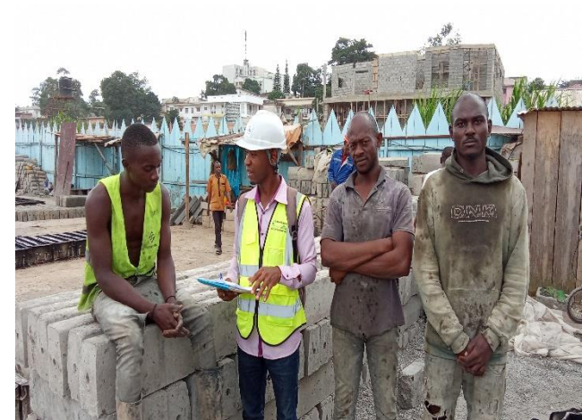
Les manœuvres présents au chantier sans EPI
