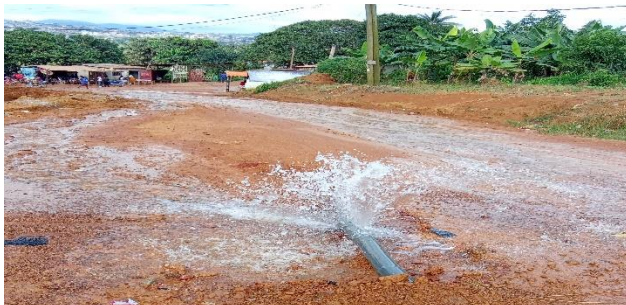
Tuyau de la CAMWATER endommager par les travaux lors du terrassement
