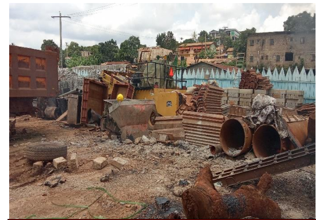
Matériaux non ranger et ordonner à la base
