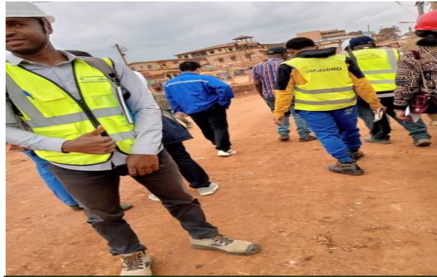
Visite guidée du chantier par la mission de contrôle conduite par le chef de mission
