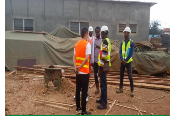
Inspection de la base logistique par l'expert socio- environnementaliste de la mission de contrôle
