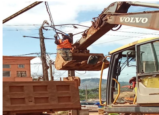
Risque de chute et d'électrocution du au mauvais manipulation
