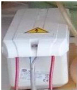
Générateur de haute Tension (10 Kv)
