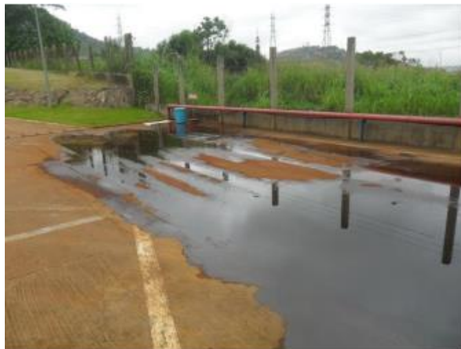
Figure 21: Déversement des produits dans le milieu récepteur dû à une fuite dans l'échangeur eau huile sortant par la purge
