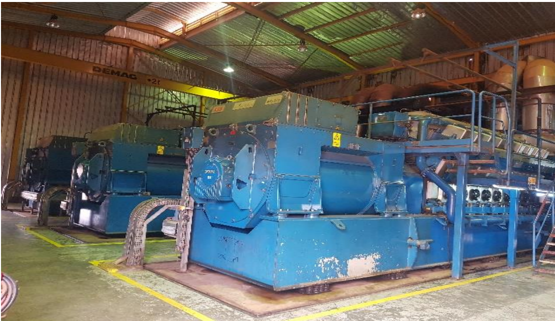
Figure 16: Illustration de la salle des machines dans les centrales thermiques
