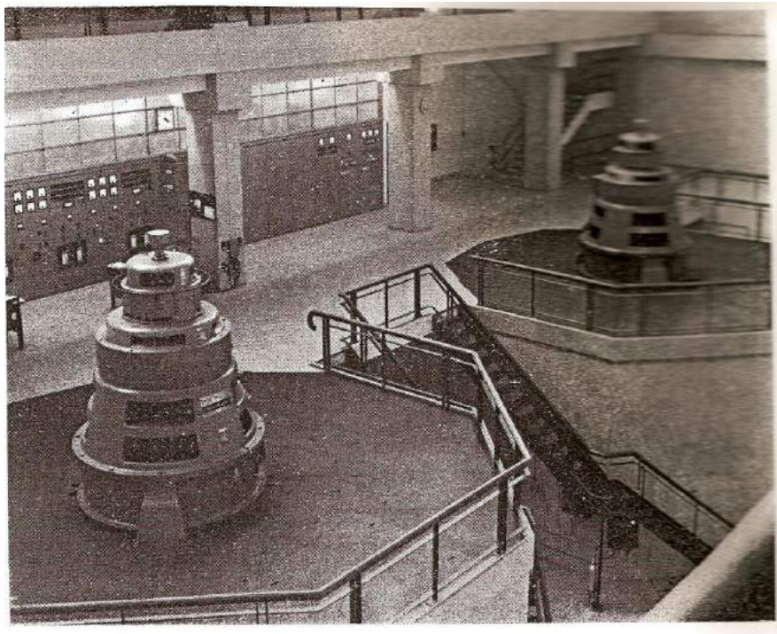
Photo n°8: Les 2 groupes de 7500 kW chacun dans la salle des machines de l'usine du Djoué.
