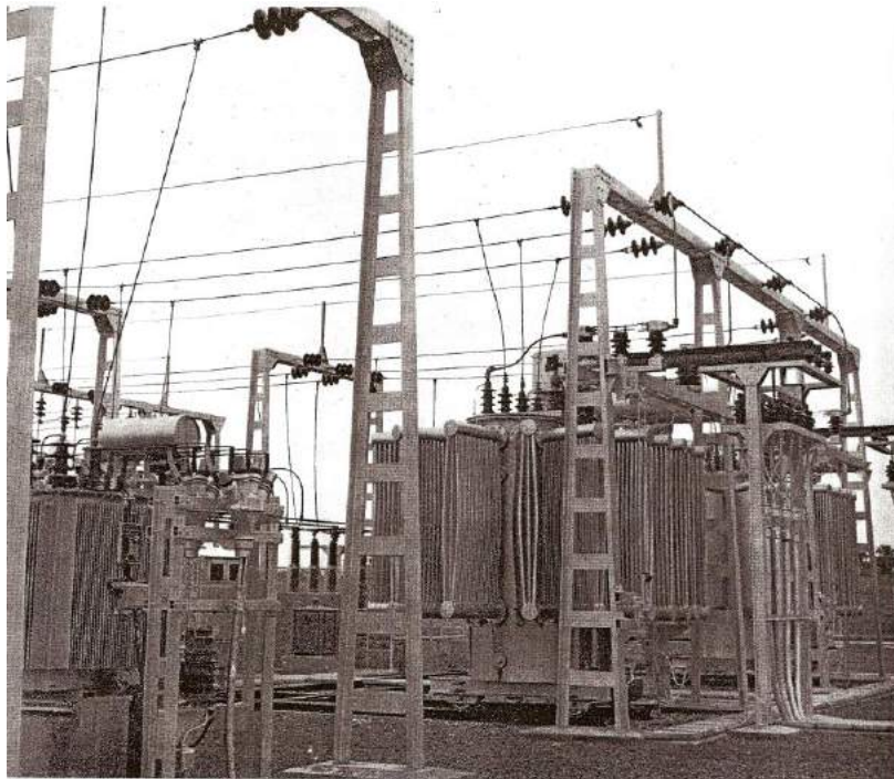
Photo n°9: Poste de transformation, abaisseur de tension, à Brazzaville.
