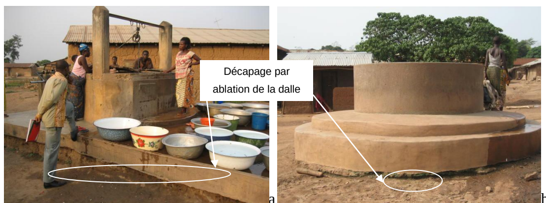
Photo 5 : Puits modernes à Bobè Djagbalo (a) et à Pira Adjadji (b)
