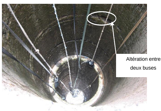
Photo 6 : Altération des parois intérieures du revêtement du puits de Bantè Gbégamey
