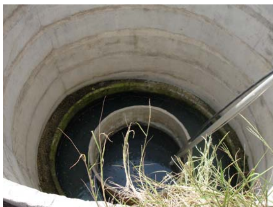
Photo 1.1 Puits busé avec tuyau relié à une motopompe installée à l'abri en surface (Photo E.Faye octobre 2005)
