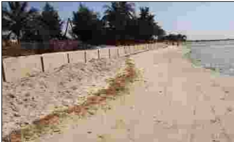
Photo 39: Mur de protection de Niodior
