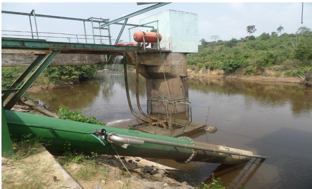
Figure 10. Station de pompage d'eau de la SODECI de la région de San-Pédro
