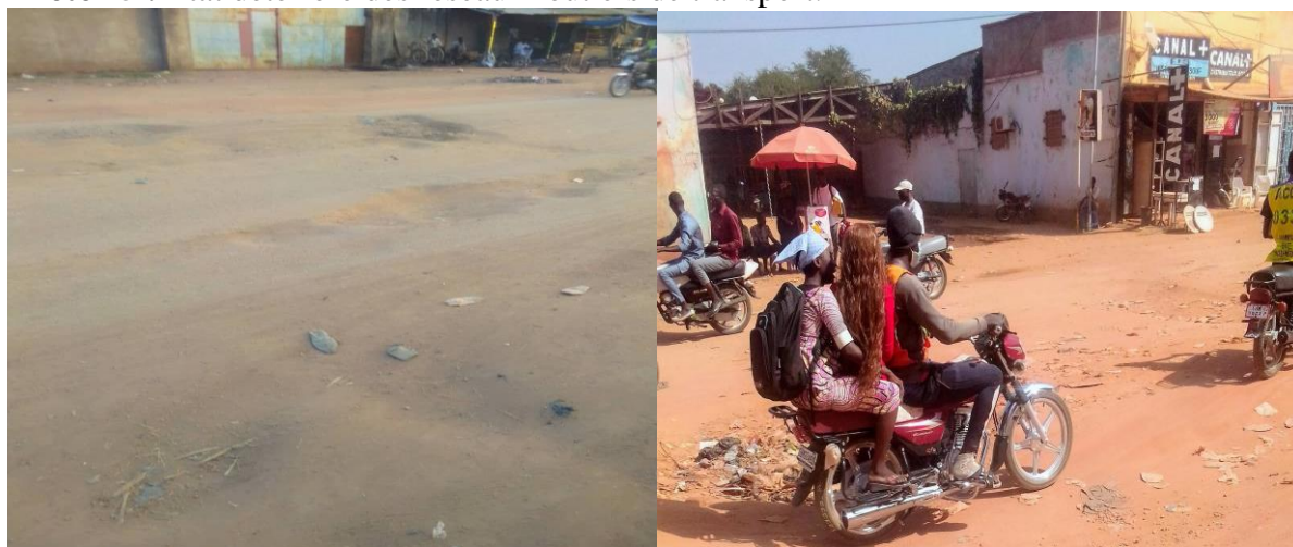
Photo 15 : État détérioré des réseaux routiers de transport.
