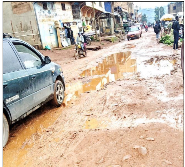
Photo 4 : Mare d'eau sur une route en terre à nkeleng
