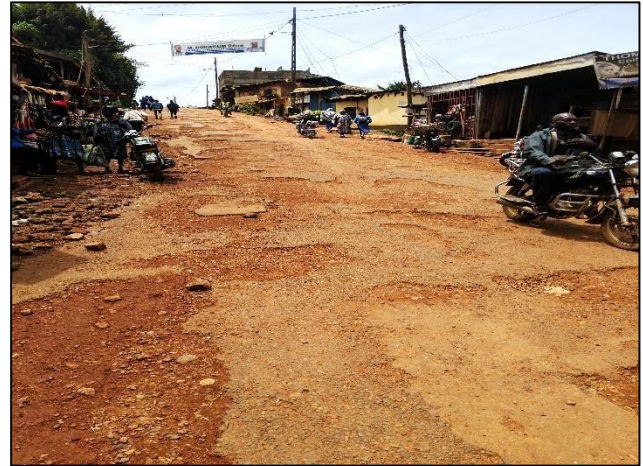
Photo 2 : route bitumée dégradée sur les bordures à Batsinglah
