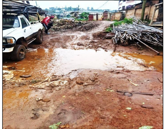
Photo 2 : Route en terre saturée par des activités humaines et avec la présence des crevasses nki
