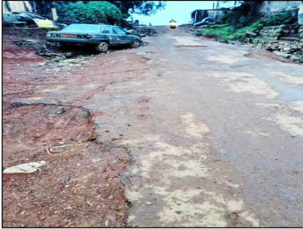
Photo 1 : route bitumée dégradée sur les bordures à Ngui
