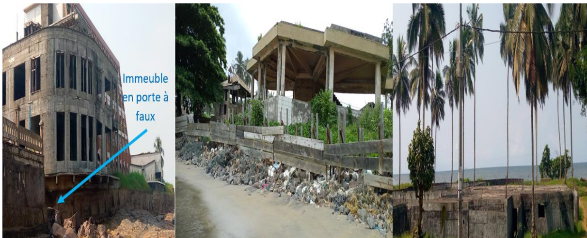
Planche Photographique 16 : Infrastructures abandonnées et détruits à proximité de la mer à cause l'avancée de la mer sur l'axe Ngoyé-grand Batanga Clichés : UM II Paul 2022
