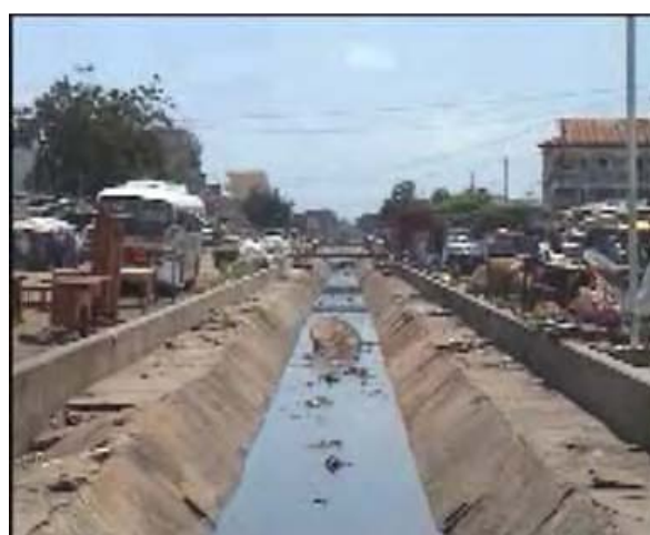
Photo 12 : Rebords d'un collecteur fissurés et affaissés au marché Dantokpa Cliché : GNELE (2009)
