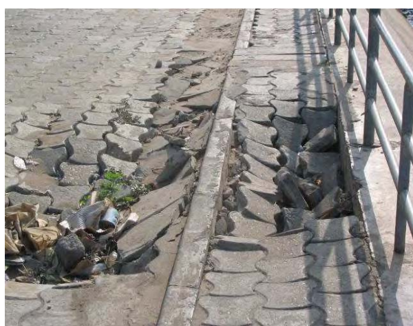
Photo 11 : Chaussée affaissée le long des voies et ouvrages à Sènané Cliché : GNELE (2009)
