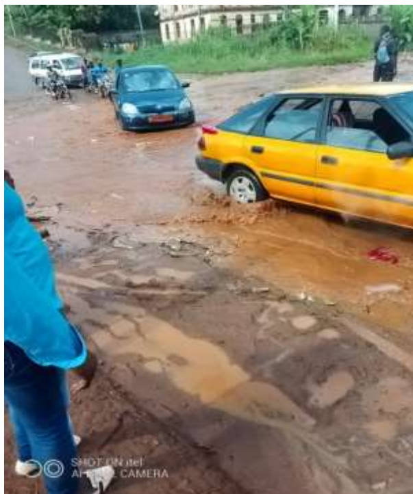
Figure 2 : route en creux stagnant l'eau en saison pluvieuse : un défaut de circulation
