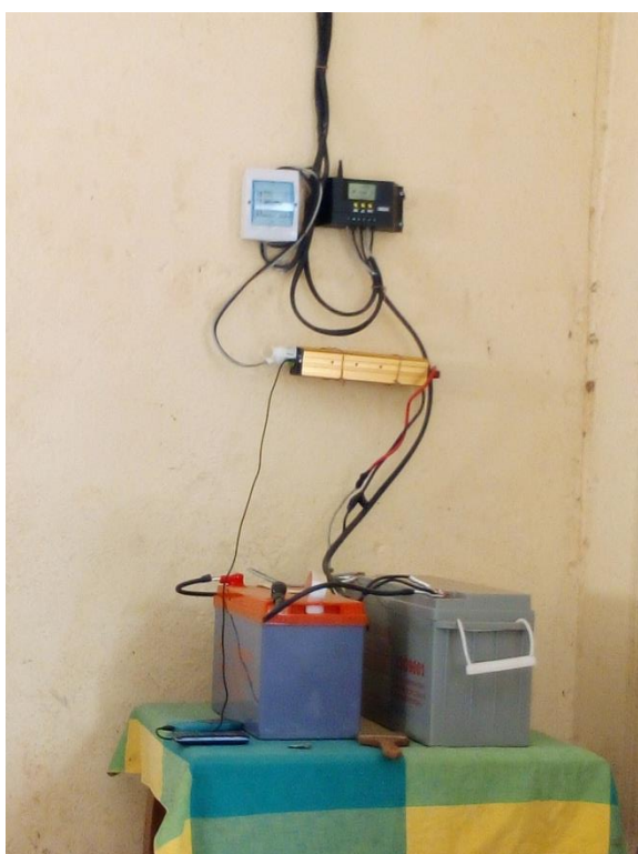
Photo 4 : Installation domestique chez un conseiller municipal au village Kpwamendjing
