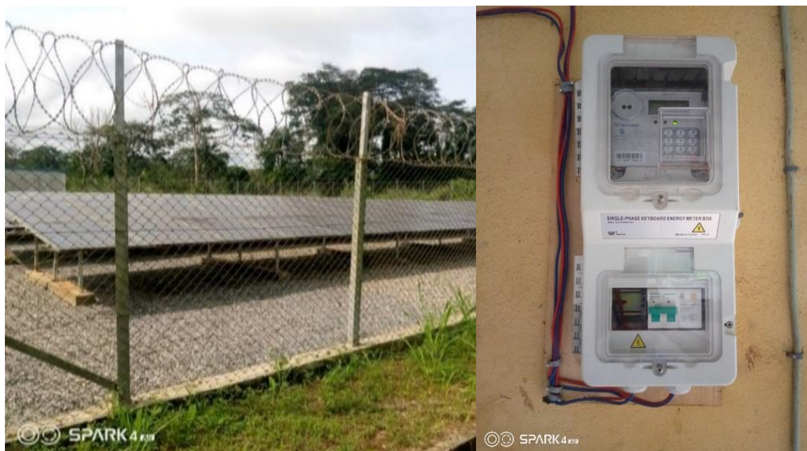
Photo 10 : Centrale à plaques solaires
