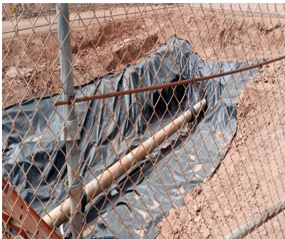
Photo 2 : Rupture du tuyau ayant causée le cas des déversements à Mouarom
