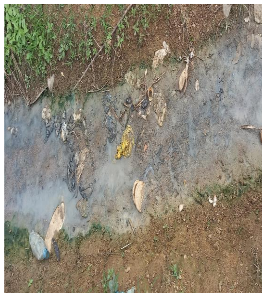
B : Ouvrage d'assainissement dans les quartiers spontanés
