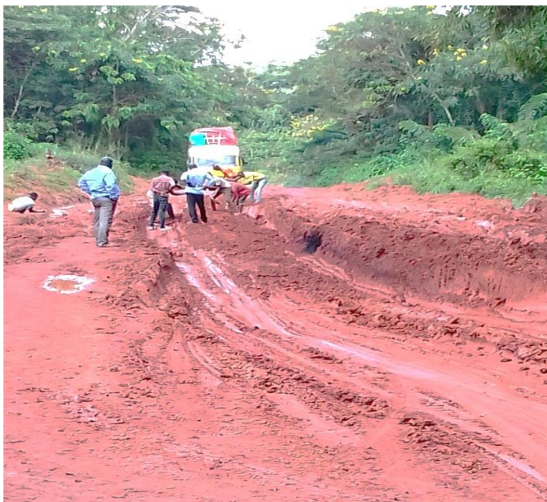
Photo 10 : Etat de la route après une forte pluie
