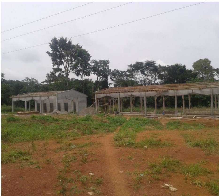
Photo 14: Construction en cours d'un petit-marché à koundou dans un espace nouvelle déboisé par la commune de Mengang
