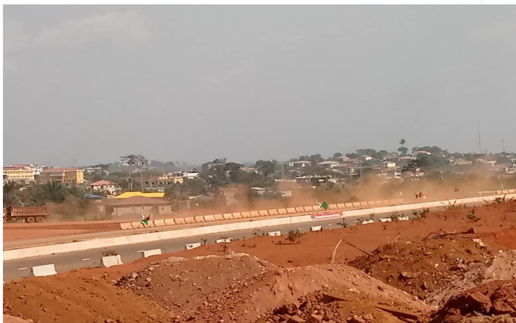
Photo 10 : levée de poussière due à la circulation des engins et enlaidissement du paysage avec le dépôt de matériaux issus des terrassements
