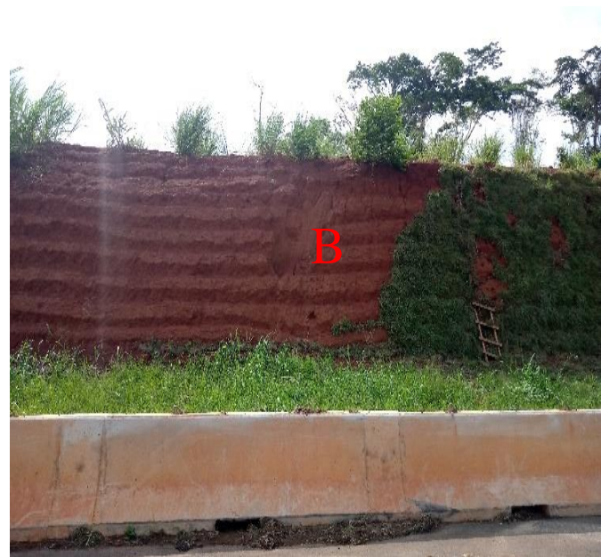
Photo B : défaillance de la végétalisation des abords de l'autoroute sur l'un des talus au quartier Meyo
