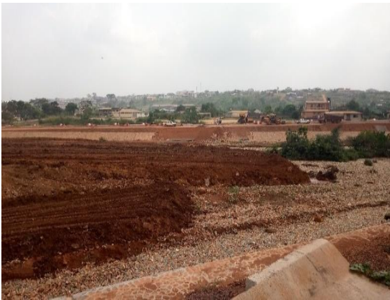
Photo A : remblaiement de la zone marécageuse d'Ahala avec enfouissement de bouteilles
