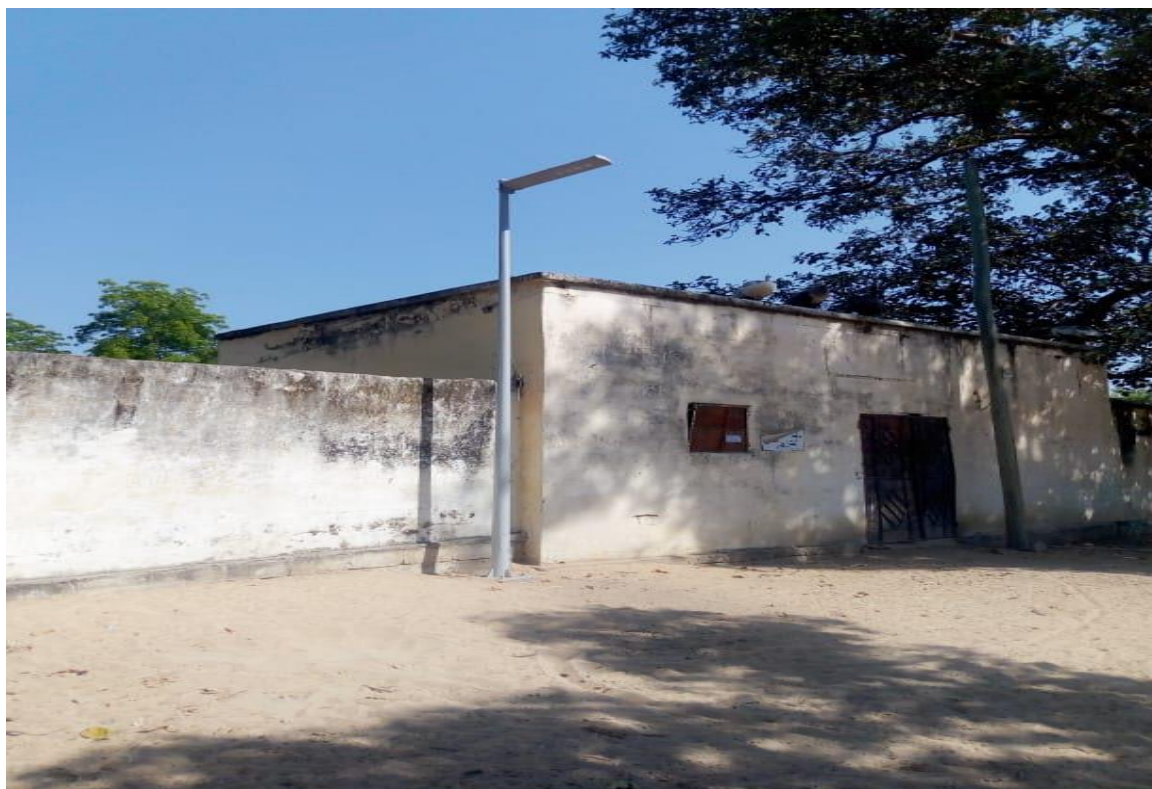
Photo 10 : Les lampes solaires installées par le PNUD à Limani
