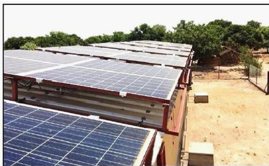
Photo 7: Système solaire installé par l'ONG « Communauté du Chemin Neuf »
